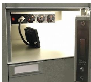
Interno sportello con prese elettriche
